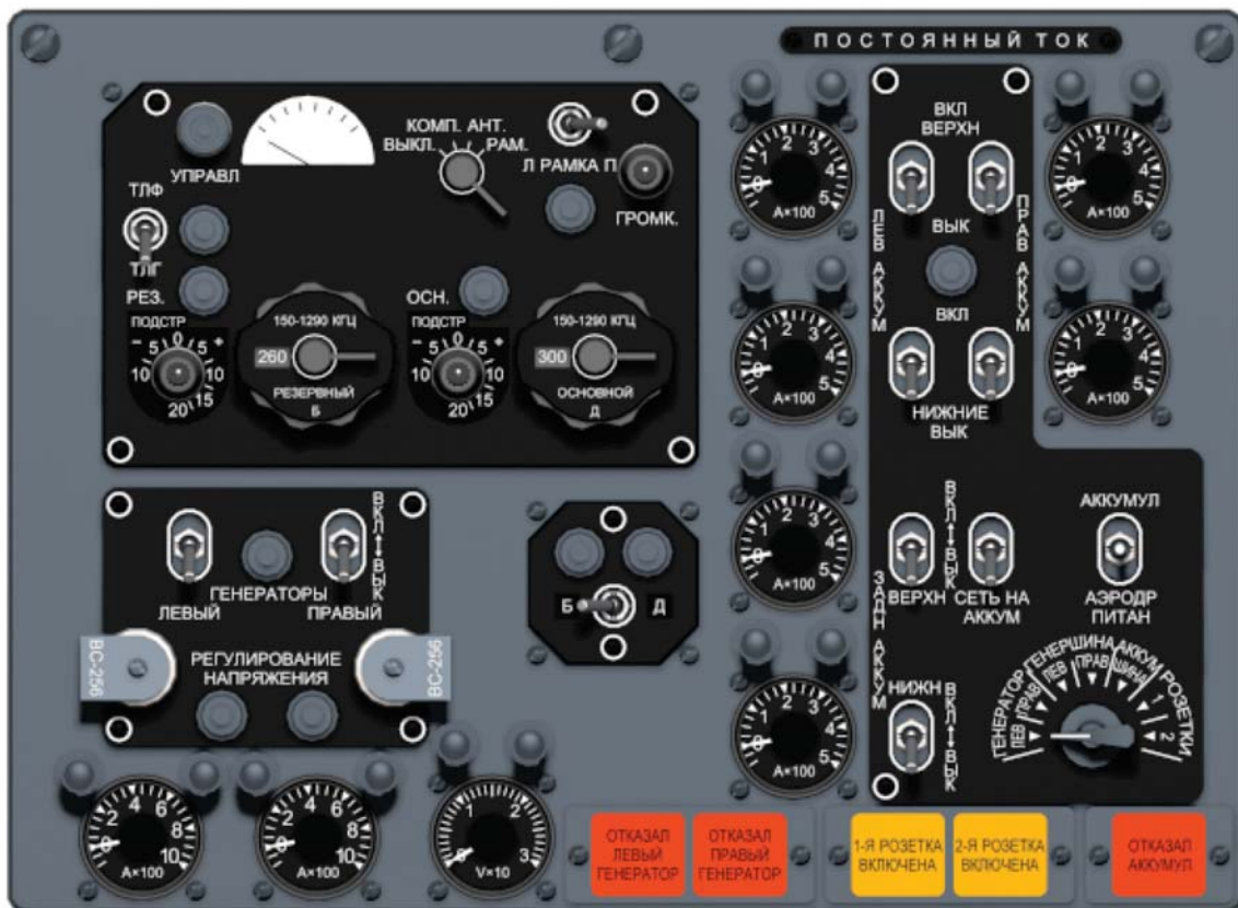
Рисунок 1.13. Щиток энергетике постоянного тока
