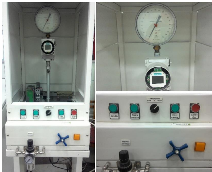
Рисунок 8 – Автоматический задатчик давления (АЗД)
