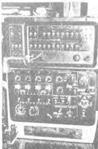
Рис.10. Панель АЭС запуска двигателей (вверху) и электро- силовой шит (внизу), расположенные в от- секе радиста
