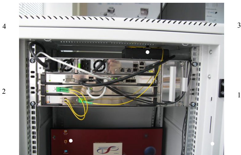
1 – телекоммуникационный шкаф, 2 – монитор, 3 – нормализующая катушка, с подключением одномодового оптического кабеля, 4 – ПАК «Дунай» компании «Т8».
